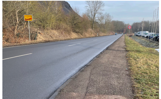
L 151 zwischen Wimmelburg und Lutherstadt Eisleben: Weg zu schmal und mangelhafter Belag
